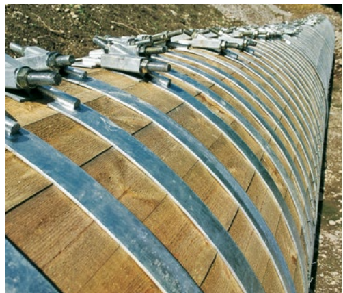
Komplett aus Kiefernholz gefertigt ist das 700 Meter lange, unterirdisch verlegte Druckrohr des Wasserkraftwerkes Zwick bei Zindelstein.
